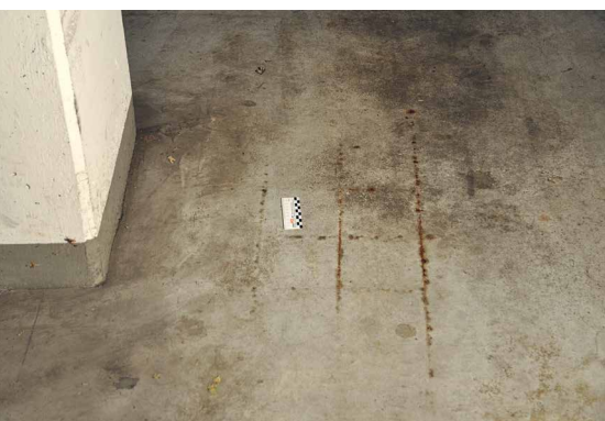
Abb. 6: Unbeschichtete Bodenplatte in einer Tiefgarage mit sich abzeichnendem Bewehrungsnetz, erkennbar an bräunlicher Verfärbung
