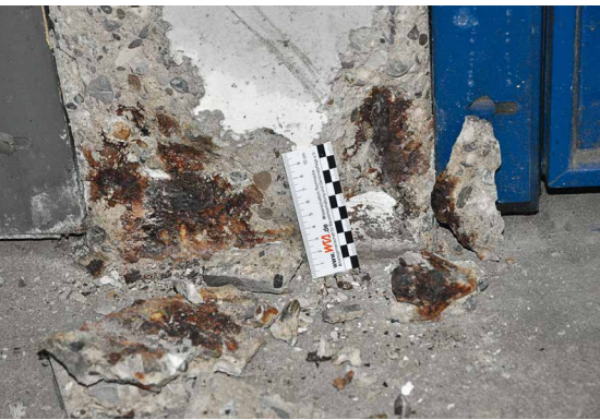
Abb. 3: Detail aus Abb. 2 nach Entfernen der gelockerten Betondeckung, chloridinduzierte Korrosion der Bewehrung
