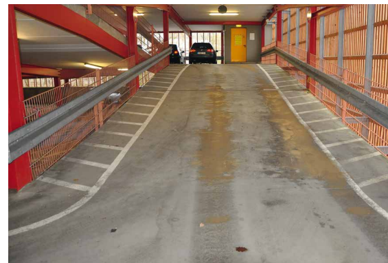
Abb. 8: Abgefahrene Deckbeschichtung an der Rampe eines Parkhauses
