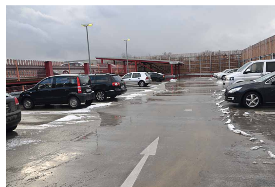
Abb. 10: Durch Befahren und Bewittern beanspruchtes Oberdeck eines Parkhauses
