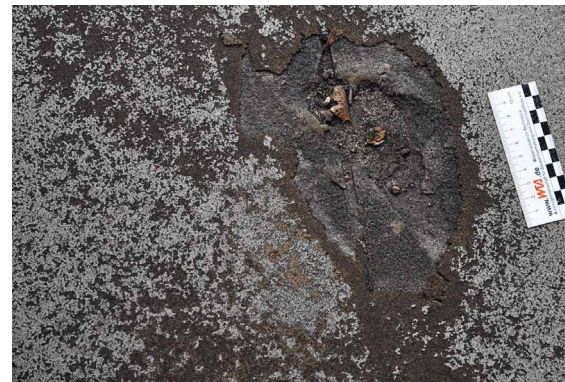
Abb. 9: Partielle Schädigung des Oberflächenschutzsystems und ungeschützt freiliegender Untergrund an einer durch Anfahrvorgänge erheblich beanspruchten Stelle eines Parkhauses
