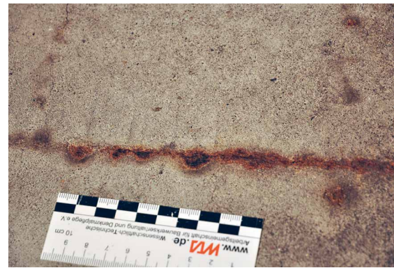
Abb. 7: Detail aus Abb. 6 chloridinduzierte Korrosion einer Bodenplatte in einer Tiefgarage
