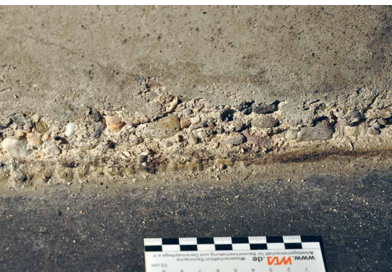
Abb. 5: Detail aus Abb. 4 – Schäden am Beton durch Beanspruchung mit Wasser und Salzen im Bereich des Sockels
