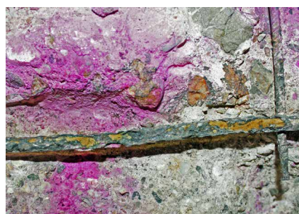
Abb. 2: Erscheinungsbild der Lochfraßkorrosion
