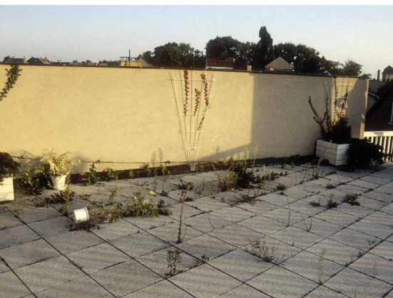
Abb. 1: Unerwünschte Dachbegrünung. Der auf der Dachterrasse mit offenen Fugen verlegte Betonwerksteinplattenbelag wurde auf Splittbett verlegt. Dort, wo in Mulden bzw. Senken der Abdichtung Wasser steht, konnten sich Pflanzen wunderbar entwickeln.
