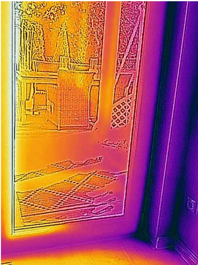
Abb. 2: Thermografie-Aufnahme des beanstandeten Bereichs des Fensterflügels
